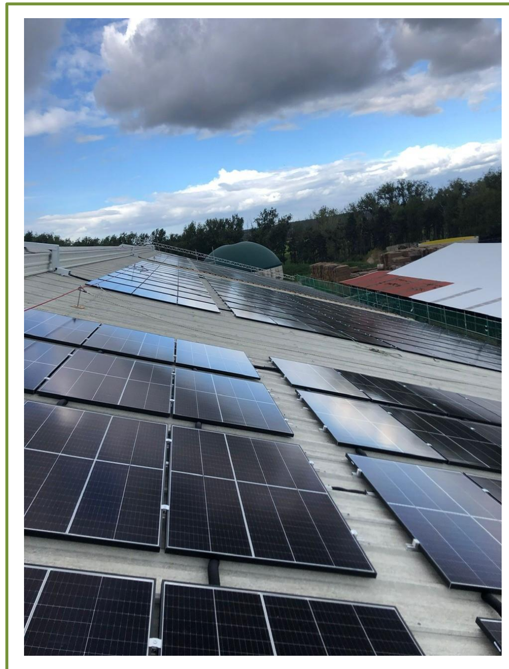
Industriebetrieb Nähe Alfeld 316 kWp
