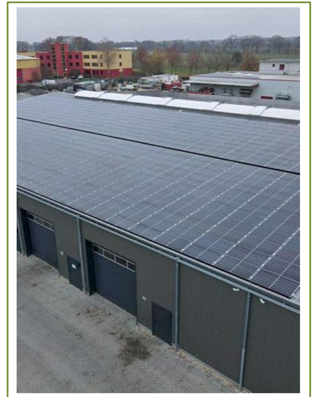
Bildungseinrichtung Nähe Güstrow 736 kWp
