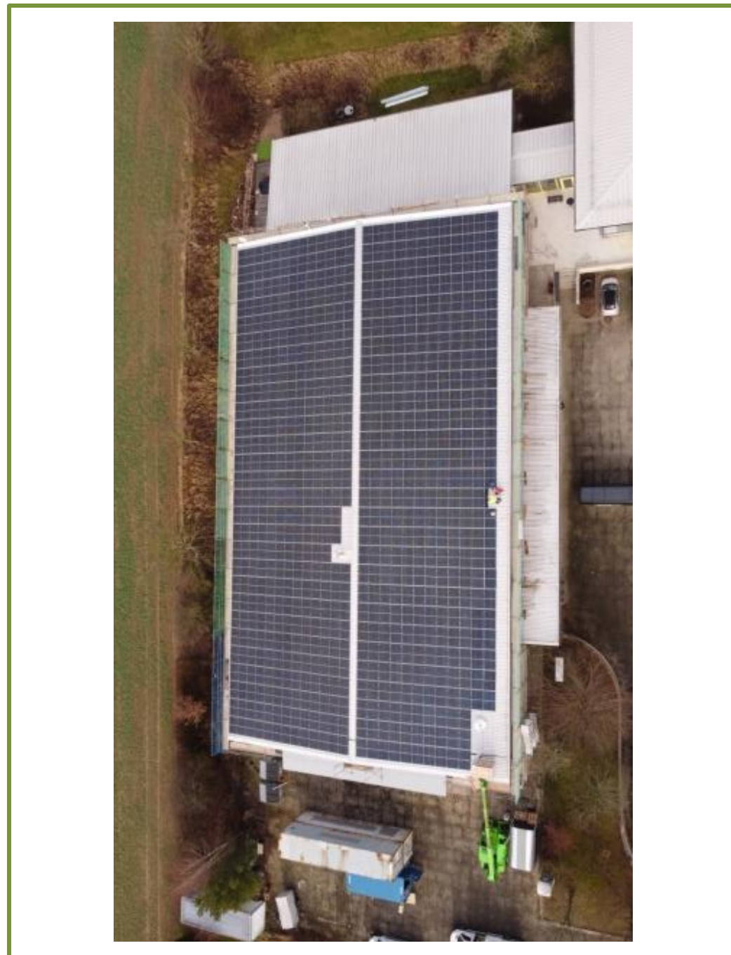
Schroth Nähe Colditz 268 kWp
