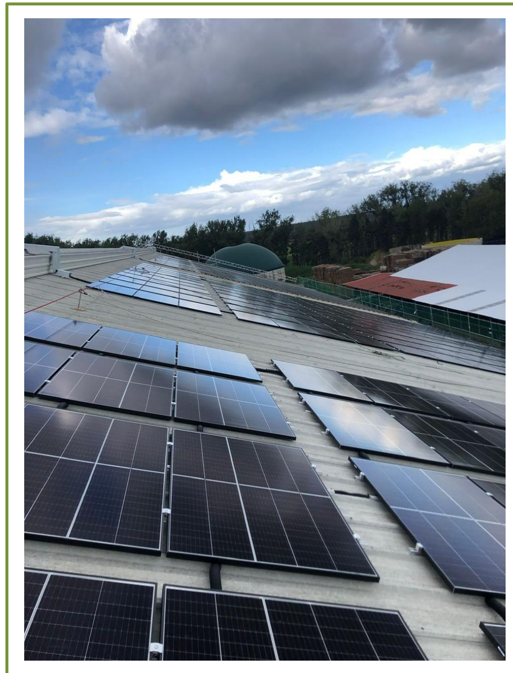
Industriebetrieb Nähe Alfeld 316 kWp
